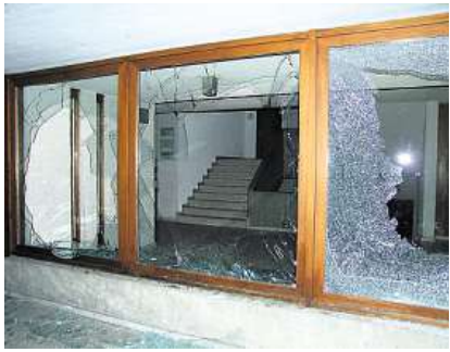
Schaden: Von den Scheiben ist nicht mehr viel übrig. Bild Kantonspolizei
